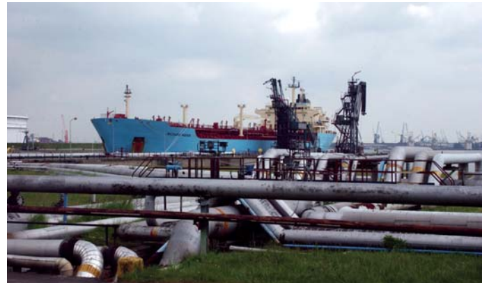
קווי צינורות (Pipeline) בנמל אנטוורפן
